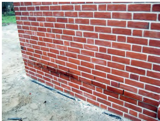
Bild 7. Verblendschale im sog. „wilden Verband“, nachverfugt. In der Steinreihe oberhalb des Sockels ist hier infolge zeitweiliger starker Durchfeuchtung eine schwarze Verfärbung durch Mikroorganismen eingetreten. (Foto: Gigla)
