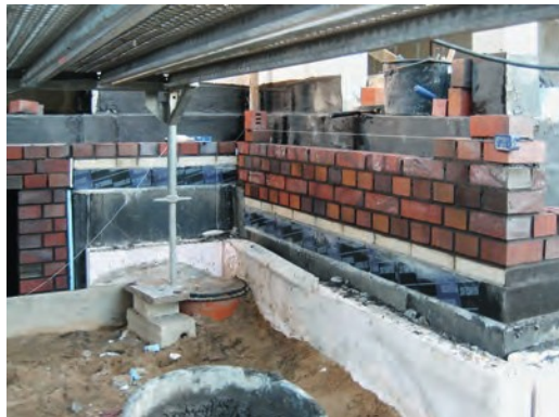
Bild 4. Gründung der Verblendschale, Sockeldetail. Ganz außen eine Perimeterdämmung. Das Kelleraußenmauerwerk ist mit Bitumen-Dachdichtungsbahnen abgedichtet. Auf dem Rücksprung am Wandkopf des Kelleraußenmauerwerks unterhalb der Verblendschale sind Wärmedämmelemente aus geschäumtem Glas mit geschlossenzelliger Struktur und eine Höhenausgleichsschicht aus Kalksandsteinen angeordnet. Die Dichtungsebene wird unter dem Wärmedämmelement zur Tragschale geführt und ist hinter der Verblendschale zu erkennen. Die spätere Geländeoberkante liegt ungefähr auf Höhe der obersten fertiggestellten Lage der Verblendschale. (Foto: Gigla)
