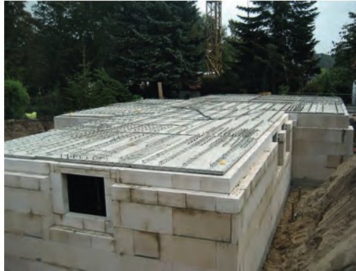
Bild 3. Kellergeschoss im Rohbau. Rechts auf der Baugrubensohle ist der Rand der Bodenplatte mit wärmedämmender Kimschicht sichtbar. Am Wandkopf der Kelleraußenwand – unterhalb der Elementplatten – ist ein der späteren Geländeoberkante angepasster Rücksprung von 36,5 cm auf 17,5 cm Wandstärke zur Auflagerung der Verblendschale zu erkennen. Das Kelleraußenmauerwerk besteht aus Kalksand-Planelementen der Abmessungen 498 mm x 498 mm (L x H). (Foto: Gigla)
